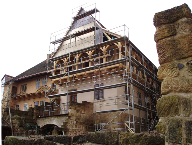
Obr. 2. Ústěck, městská památková rezervace, dům čp. 18, tzv. gotické dvojče, rekonstrukce shořelého patra. Foto: Stanislav Flesar.
