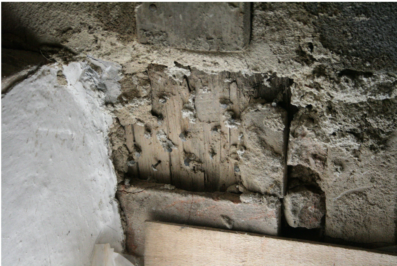
Obr. 7. Trám vynášející klenbu černé kuchyně pobitý druhotně kovanými hřebíky s motýlovou hlavou k uchycení omítky. Foto: Kamil Podroužek.
