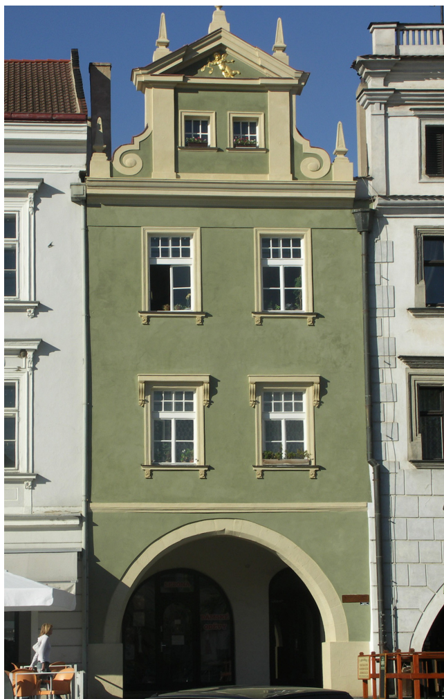
Obr. 4. Litoměřice, městská památková rezervace, Mírové náměstí čp. 11, příklad zdařilé obnovy hlavního průčelí opět za pomoci vápenné technologie. Foto: Lucie Radová.
