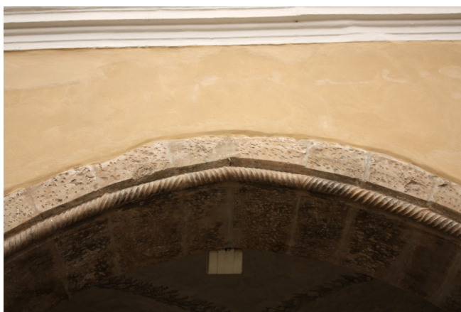
Obr. 4. Žatec, městská památková rezervace, nám. Svobody čp. 46, tzv. Hošťálkův dům, detail nesprávného řešení kamenných prvků v kontrastu s omítkovými plochami fasád. Foto: Lucie Radová.
