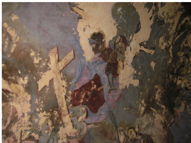
Obr. 1. Louny, kostel Čtrnácti sv. Pomocníků, malby na klenbě presbytáře – výchozí stav. Foto: Vít Honys.
