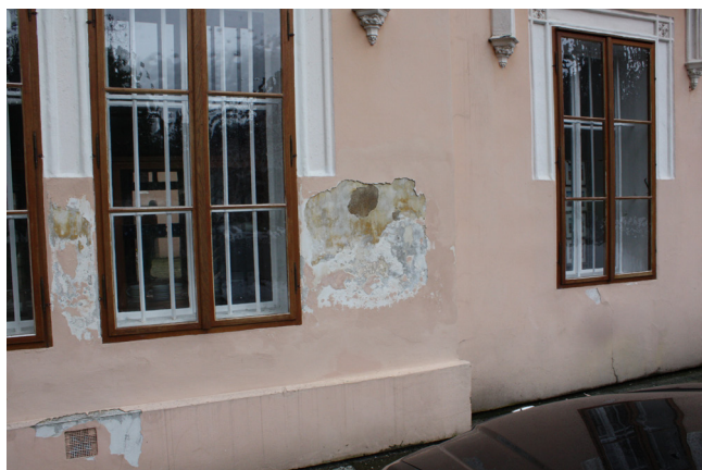
Obr. 2. Klášterec nad Ohří, zámek, detail poškození fasádního nátěru, 2010. Foto: Martin Zubík.
