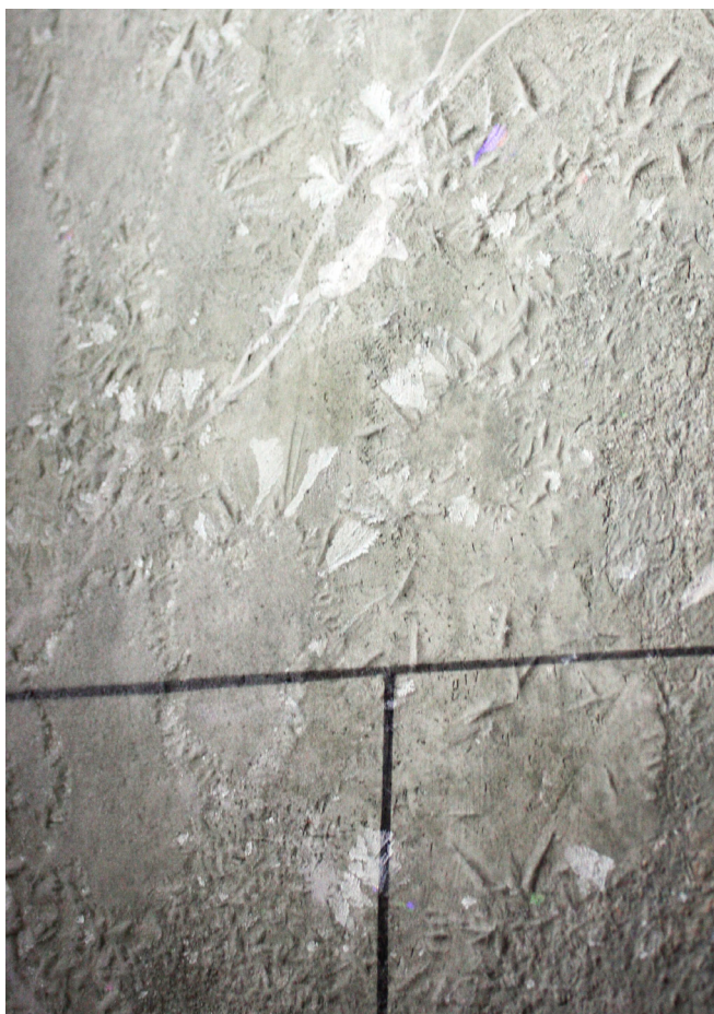
Obr. 11. Rumburk, Svaté schody, promrzlá stěna kaple Kalvárie, leden 2010. Foto: Eva Francová.
