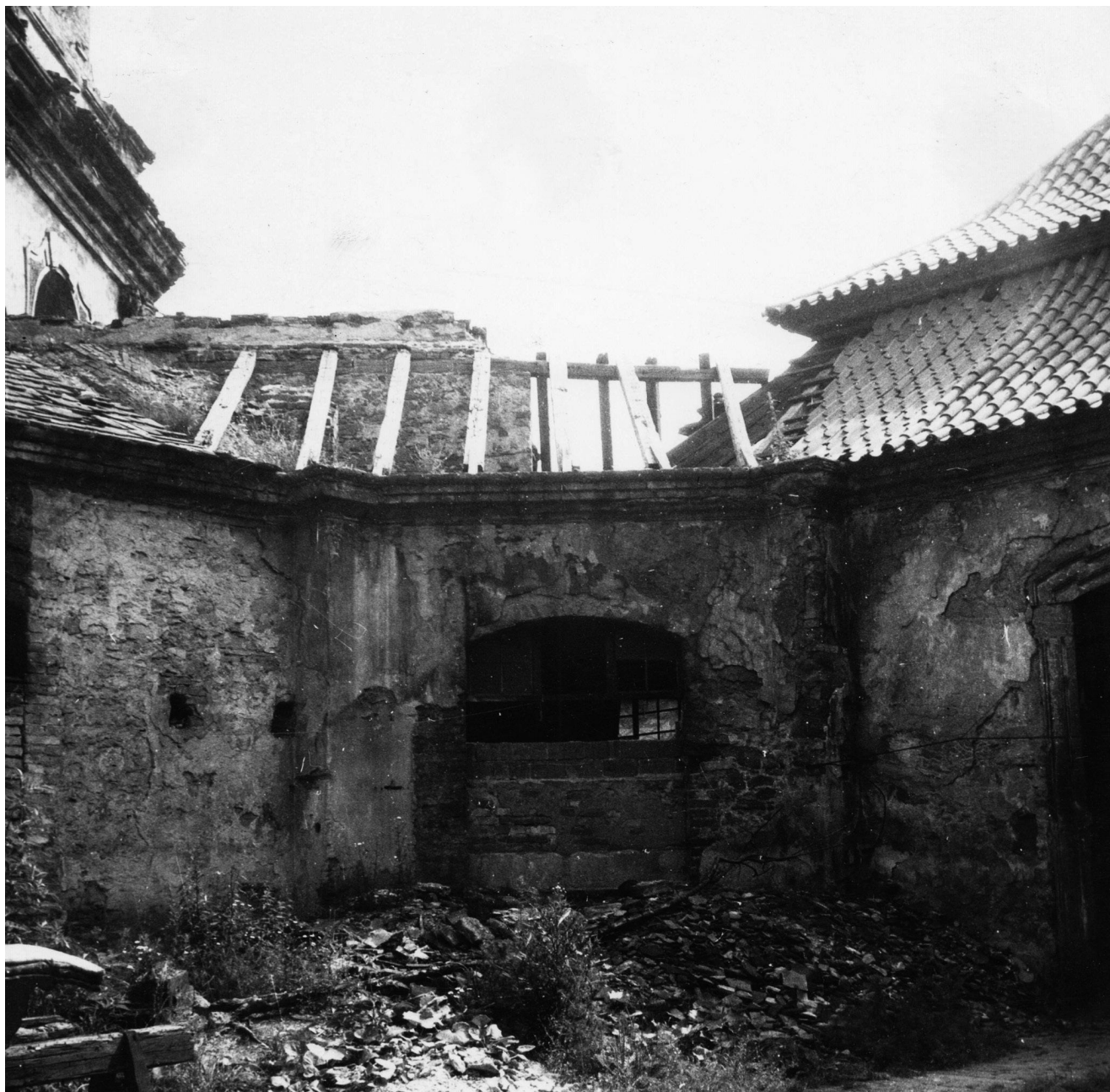
Obr. 10. Pohledy na zchátralé části špitální budovy, MMD, Barokní památky v Duchcově (špitál a kaple sv. Barbory), S–XXXII, fotografie, nedat., sine pag.
