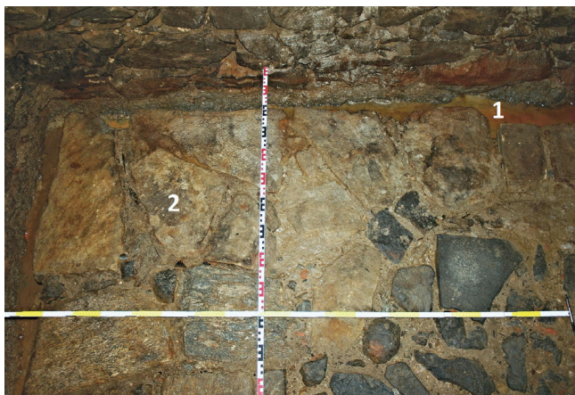
Obr. 13. Západní nároží podlahy s drenážním kanálkem (1) a šibrovými nárožníky (2), foto K. Podroužek
