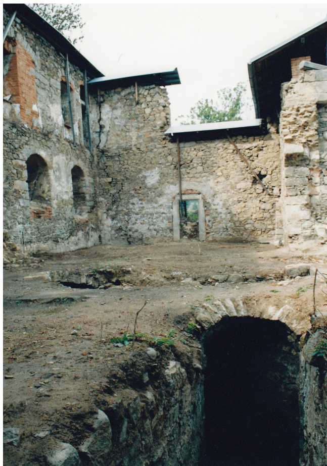
Obr. 8. Zřícená klenba schodišťové vstupní šíje jižního sklepa, stav v roce 2003, foto J. Koloc, agenda OEDIS, NPÚ ÚOP v Ústí n. L.
