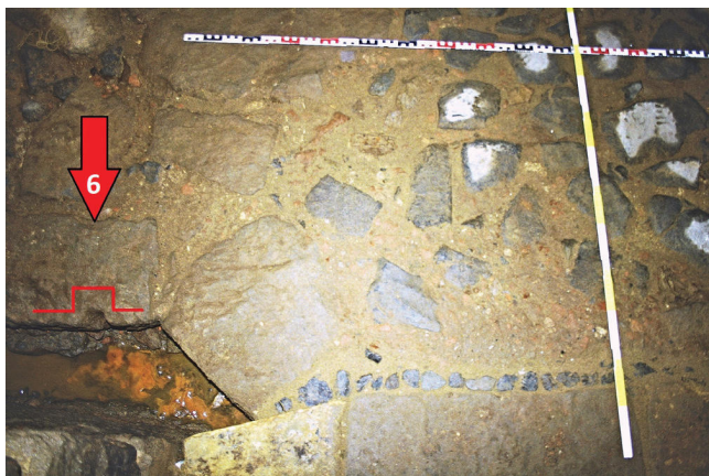
Obr. 18. Dlažba u vstupu do sklepa s drážkou pro hradítka kanálku (6), foto K. Podroužek.
