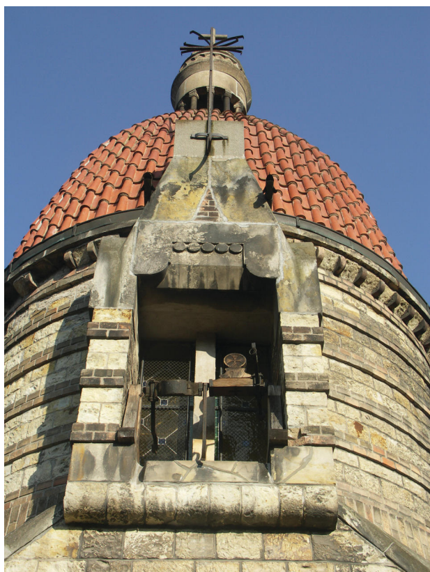
Obr. 5. Vlčí, kaple sv. Václava, detail zvonice, pohled od J. Foto: Jiří Bureš, 6. 3. 2013.
