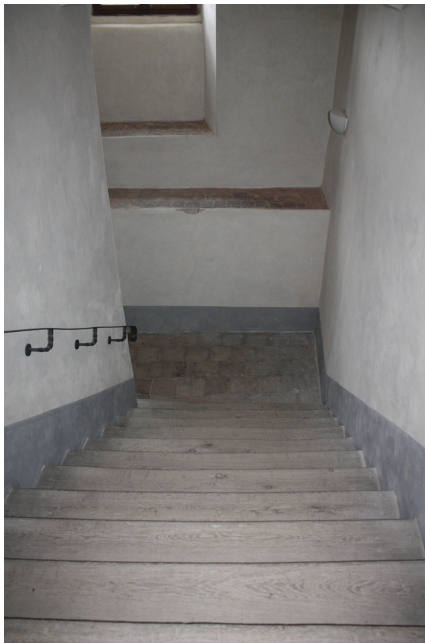
Obr. č. 5. Schodiště do prvního patra severního křídla po očištění a provedení výmalby. Foto: Lucie Radová, 2014.
