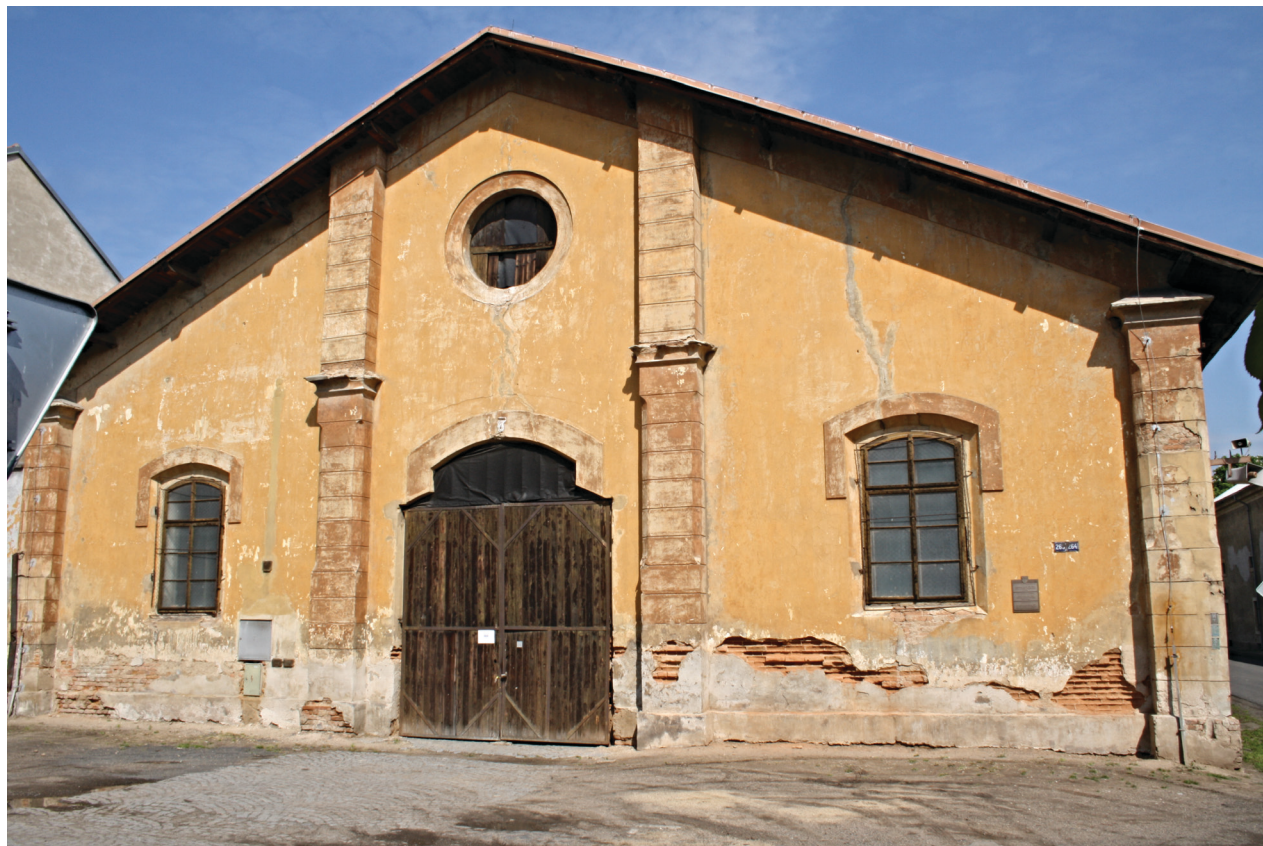
Obr. č. 1. Celkový pohled od jihu na jižní průčelí. Stav před opravou v roce 2012. Foto: Jaroslav Skopec, 2012.
