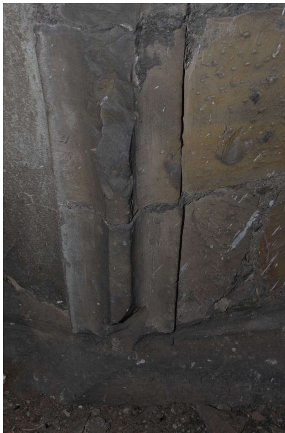
Obr. 19. Stopy po odstraněných kružbách v oknech zvonového patra věže. Foto: Tomáš Brož, 2015.
