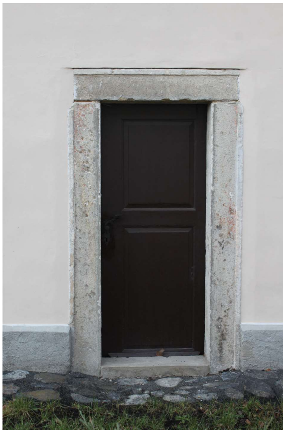
Obr. 22. Detail severovýchodního vstupu do presbytáře, patrné je druhotné sesazení ostění. Foto: Tomáš Brož, 2015.
