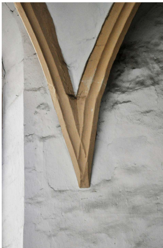
Obr. 17. Detail výběhu druhotně vložené klenby staršího presbytáře kostela s přetínavými hranami žeber. Přetínavé hrany žeber lze vnímat jako jeden z typických znaků pozdní gotiky saského typu. Prezentovaná klenba byla do hmoty reliktu staršího kostela z pol. 14. století vložena při generální přestavbě kostela kolem roku 1484. Foto: Táňa Šimková 2014.
