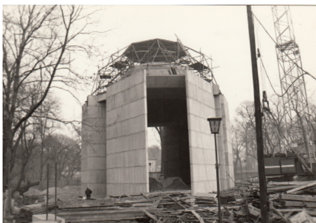
Obr. 11. Modelace pláště tenkých nosných stěn pavilonu pro Reinerovu fresku, léta 1975–1976, fotografie; MMD, Barokní památky v Duchcově (Zbouraný špitál a kaple sv. Barbory), S-XXXII, nečíslováno.
