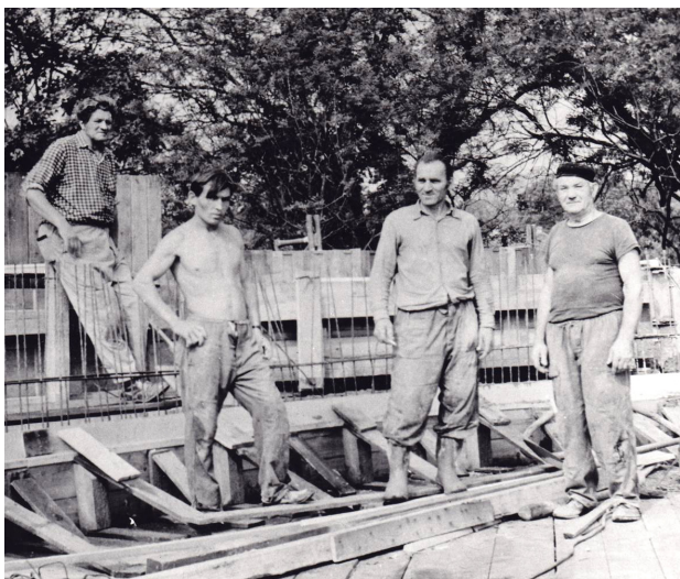
Obr. 16. Dělníci na stavbě pavilonu pro Reinerovu fresku, kolem roku 1973; MMD, Barokní památky v Duchcově (Zbouraný špitál a kaple sv. Barbory), S-XXXII, nečíslováno.
