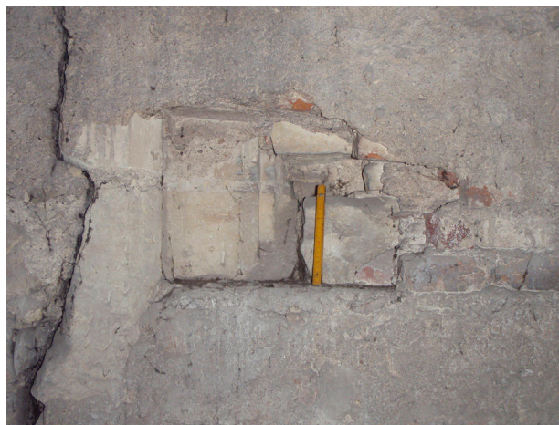
10) Litoměřice, kostel Všechných svatých. Ostění západního okna v jižní zdi hlavní lodi. Foto: Miroslav Kovář, 2019.
