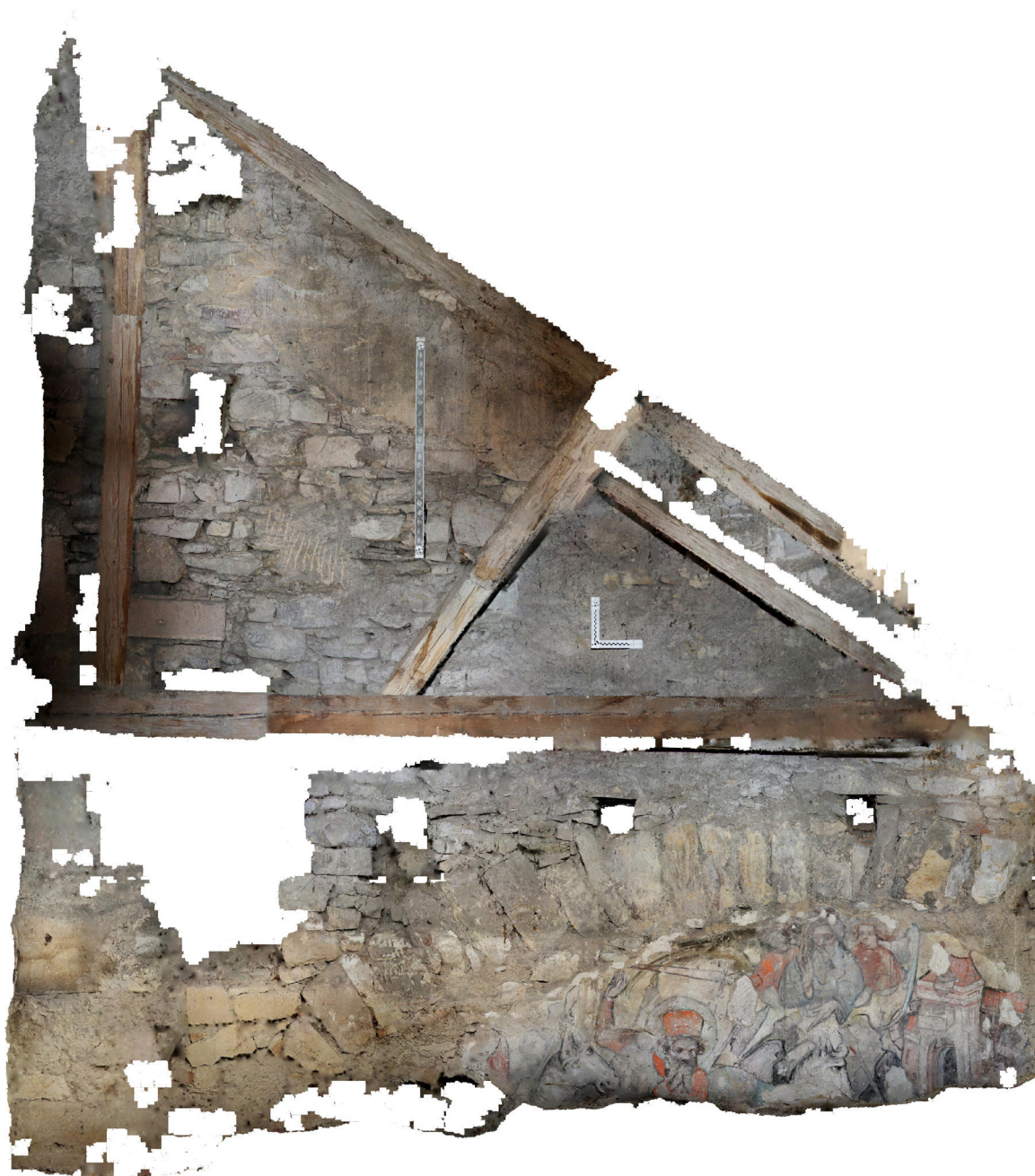
5) Litoměřice, kostel Všech svatých. Fotoplán východní stěny v podkroví třetího pole jižní boční lodi. Autoři: Petr Hasil, Jaroslav Skopec, 2021.
