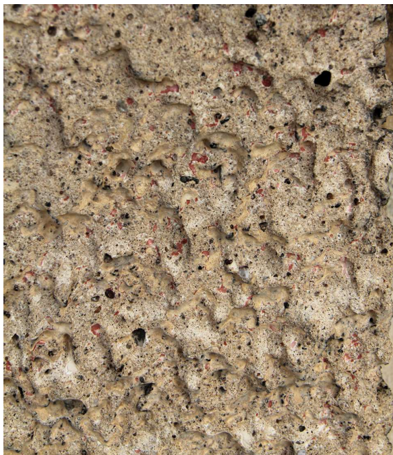
Obr. 5. Zahořany, kostel Nejsvětější Trojice, jižní průčelí, detail struktury stříkané stékové omítky iluzivního kvádrování s relikty raně barokní červené barevnosti v prohlubních. Foto: Táňa Šimková, 2014.
