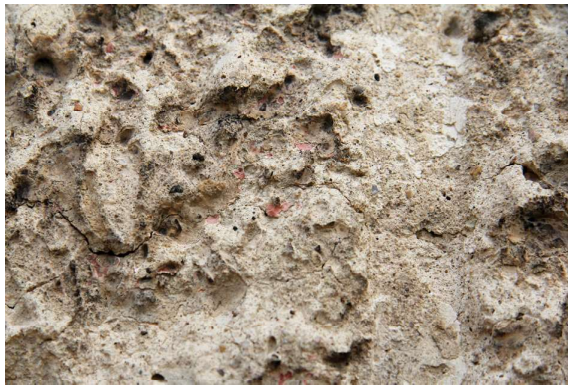
Obr. 6. Zahořany, kostel Nejsvětější Trojice, jižní průčelí, detail kontrastu za líc zahlazené spáry s relikty bílého vápenného nátěru a stříkané stékové omítky iluzivního kvádrování s relikty raně barokní červené barevnosti v prohlubních. Foto: Táňa Šimková, 2014.
