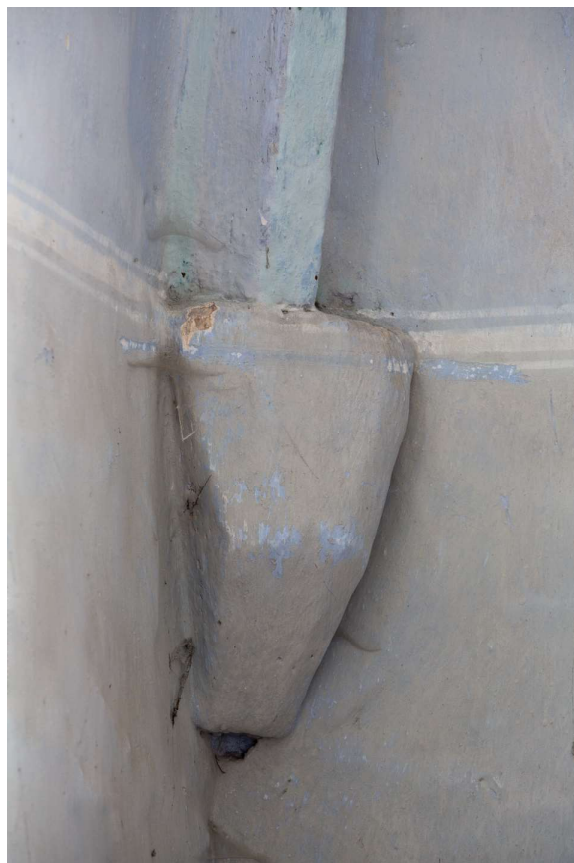
Obr. 13. Detail severovýchodní konzole klenby presbytáře. Foto: Kateřina Neumannová, 2016.
