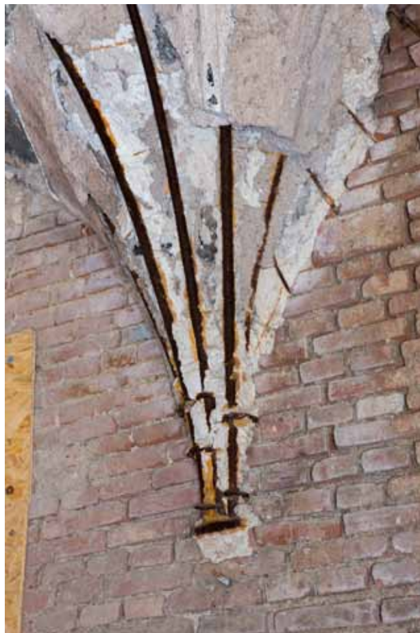
Obr. 19. Hrob, chrám Vzkříšení, destrukce výběhu klenby s odhalenou výztuží, detail. Foto: Marta Pavlíková, 2017.
