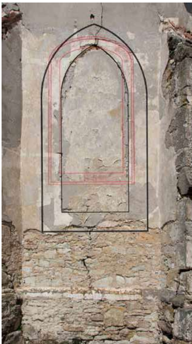
Obr. 12. Fotoplán jihovýchodního průčelí presbytáře se zákresem rekonstruované podoby šedě malované šambrány kolem hrotitého okenního otvoru (černě) a červeně malovaného barokního iluzivního okenního otvoru s páskem (červeně). Foto a kresba: Jaroslav Skopec, 2018.
