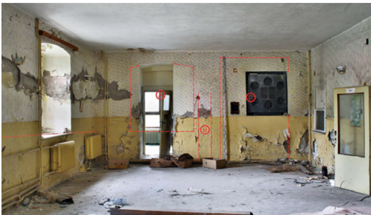
Obr 15. Jižní strana refektáře v pohledu od severu. A – Původní okenní otvor upravený v 50. letech 20. století na vstup; B – negativ obvodové zídky topeniště; C – Nika topeniště. Foto: Jaroslav Skopec, 2017
